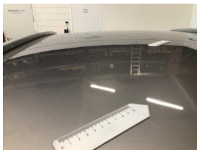
Dak Lichte Hagelschade 15 X Deukje
