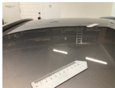
Dak Lichte Hagelschade 15 X Deukje
